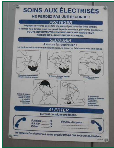
Panneau d'information des soins aux électrisés sur le transformateur électrique de l'installation de traitement de la société à Luxémont-et-Villotte
